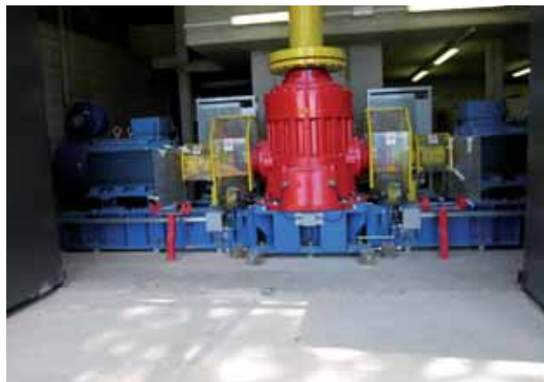
Cabina motori di un'altra teleferica a Renon (Bolzano)
